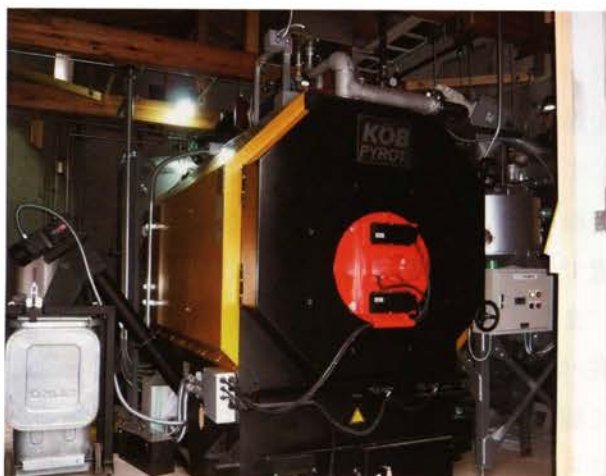
「かぐらの湯」のバイオマスボイラー
