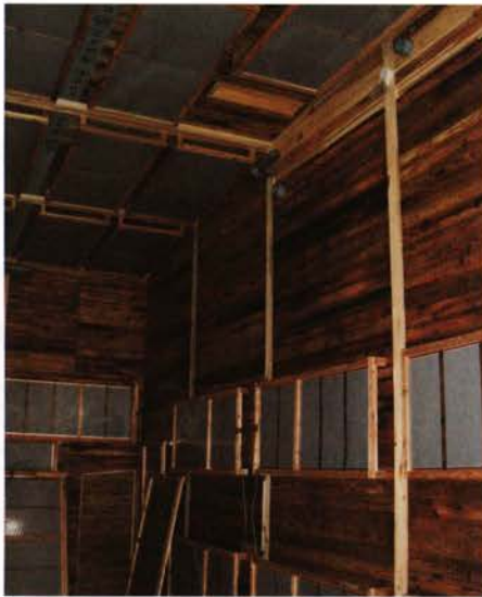
木造乾燥機内部
