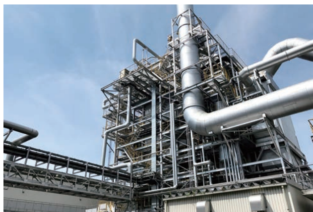
真庭バイオマス発電所
