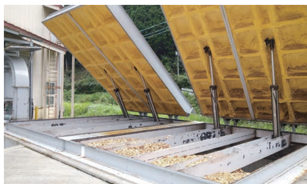
バイオマス発電所のチップサイロ(投入口)
