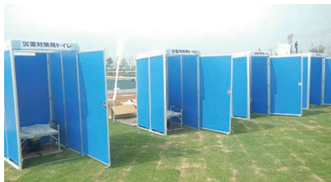
ウェルネスタウン内のマンホールトイレ
