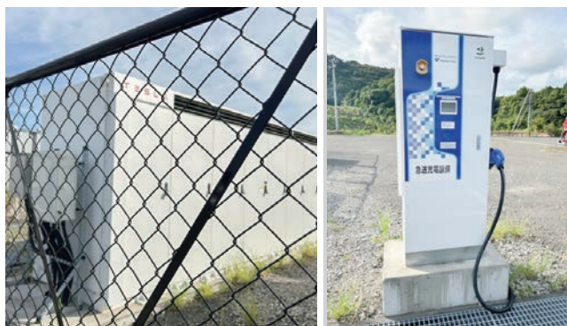
黒潮町役場内 大型蓄電池 黒潮町役場内 急速充電設備
