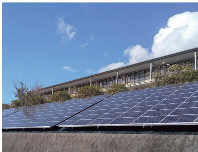
太陽光パネル
