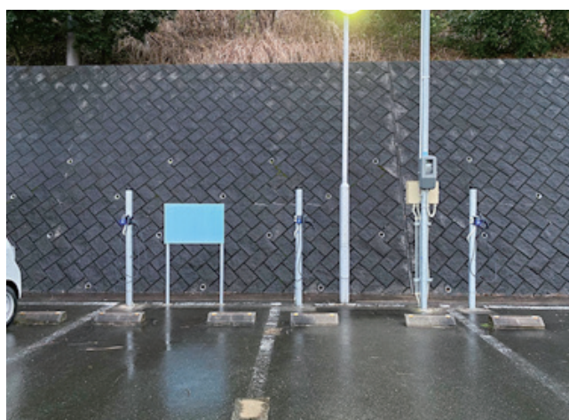
急速充電器の設置
