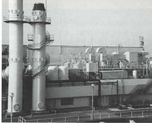
金町浄水場コジェネレーション施設
