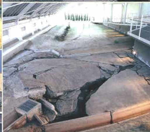
野島断層保存館内の断層による道路の破壊部分 （左手の山側の部分の地面が持ち上がり、右にずれている）
