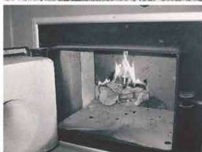
(上) チップボイラー (中) チップサイロ (下) たき始めの炉内の状況
