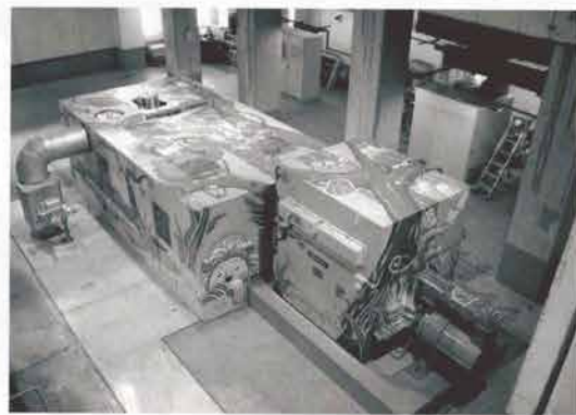
蒸気タービン
