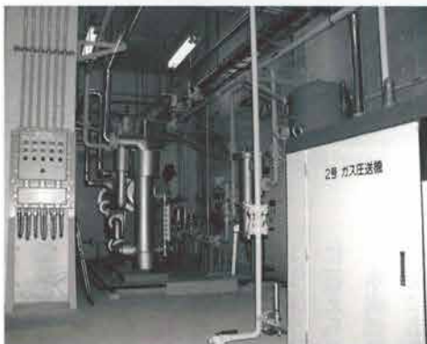
約8気圧に保たれている供給先のガスホルダーに精製ガスを9気圧に加圧して送り出す圧送棟内部
