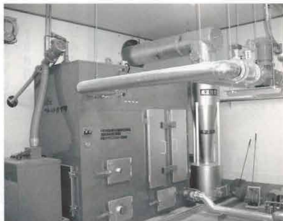
紫波町立上平沢小学校のペレットボイラー
