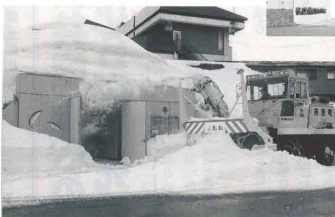
雪冷房システムの貯蔵槽への雪投入。右上は体験学習館
