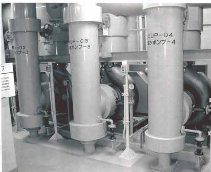
海水取水ポンプ
