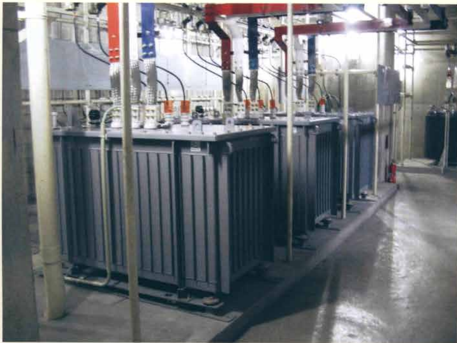
佐賀市役所が導入した アモルファストランス。 変圧時のロスが少ない
