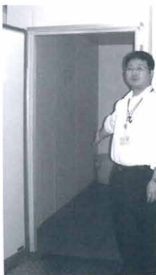
伊藤忠ビルの地下にある残飯の一時保存用冷蔵庫
