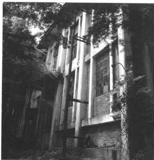
北炭幌内炭鉱変電所
