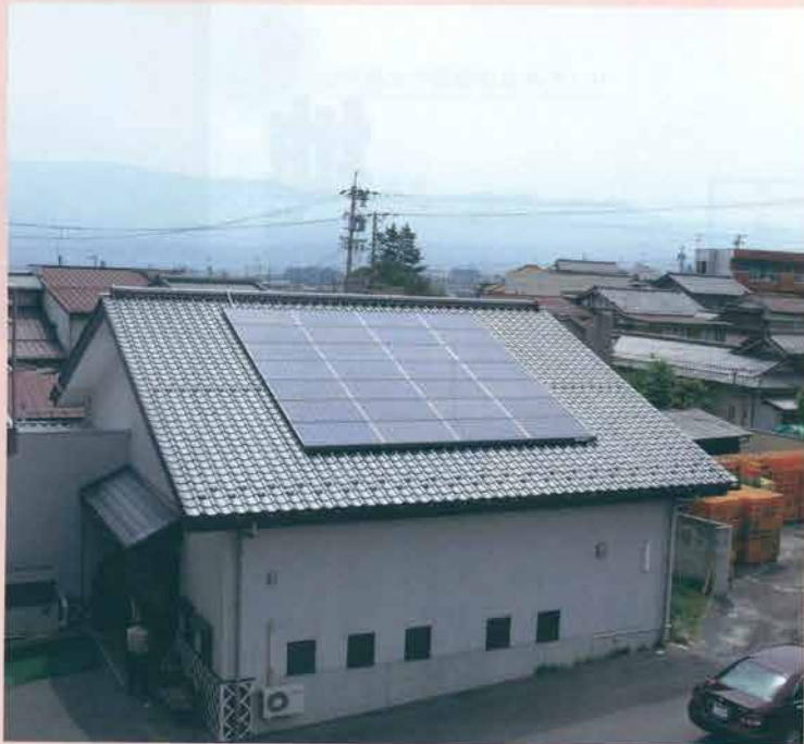
酒造会社に設置された太陽光発電 ●「おひさまファンド」(長野県飯田市) (p20-21)
