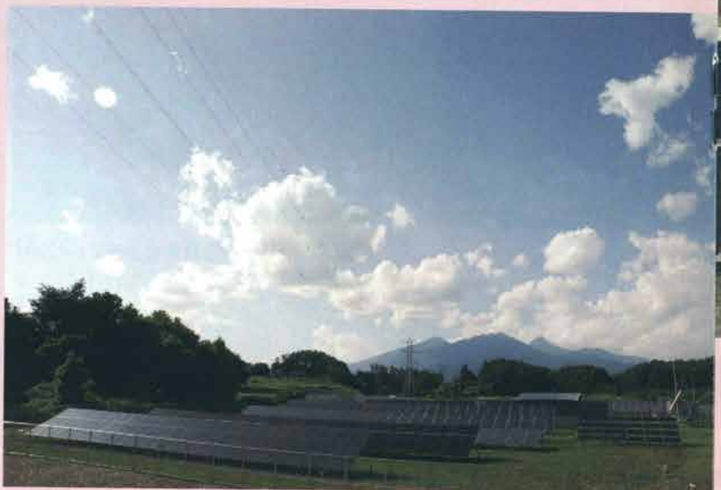
山梨県北杜市 ●山梨県 (P31) 太陽光発電施設
