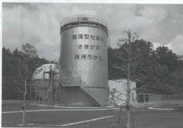
メタン発酵槽
