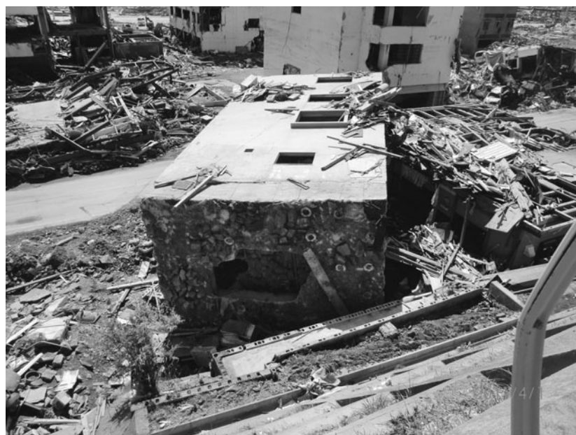
倒壊した4階RC建物（基礎が不十分であったと考えられる、女川）
