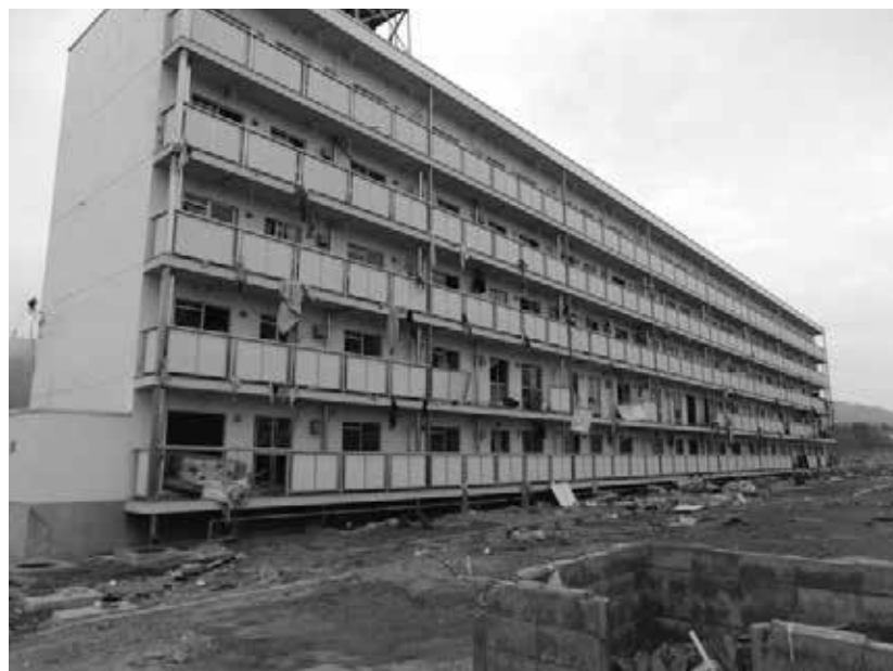
構造的に無損傷で残ったRC集合住宅（5Fまで津波が達している、陸前高田）
