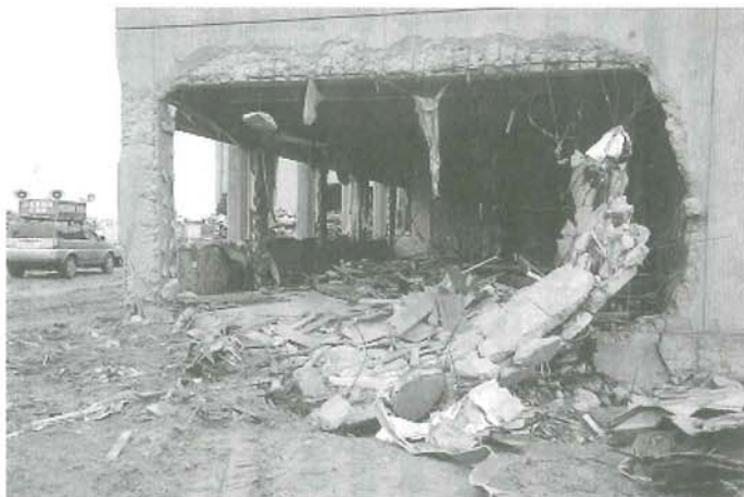
写真1 陸前高田市立図書館：窓からなだれ込んだ水流のすさまじい破壊力 (社) 日本図書館協会撮影
