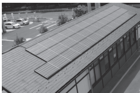
市民共同発電所1号機 「八日市やさい村」屋上 5.99kw
