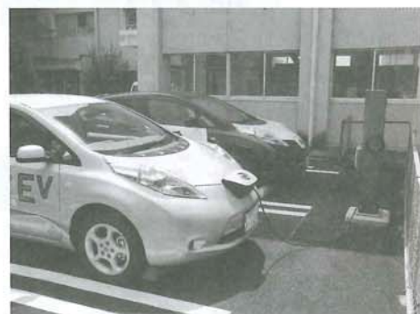
無料で利用できるEV充電器
