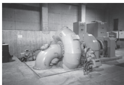
那須野ヶ原発電所内部：横軸フランシス水車と発電機
