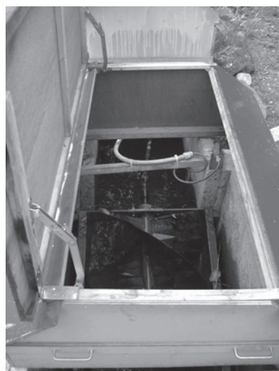
川上ミニ水力発電所
