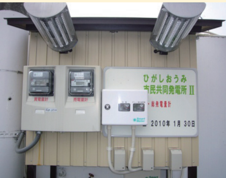
自然エネルギーの活用が可視化できるスマートメーター ● 滋賀県東近江市 (p22-23)
