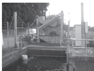
那須野ヶ原発電所に導水するヘッドタンクに設置された除じん施設
