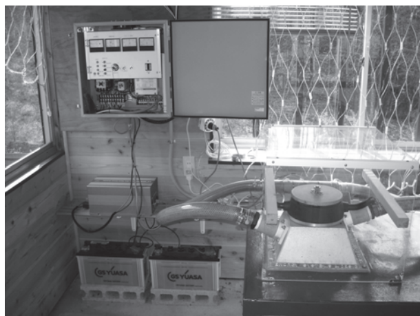
谷川区に導入したピコ水力発電設備
