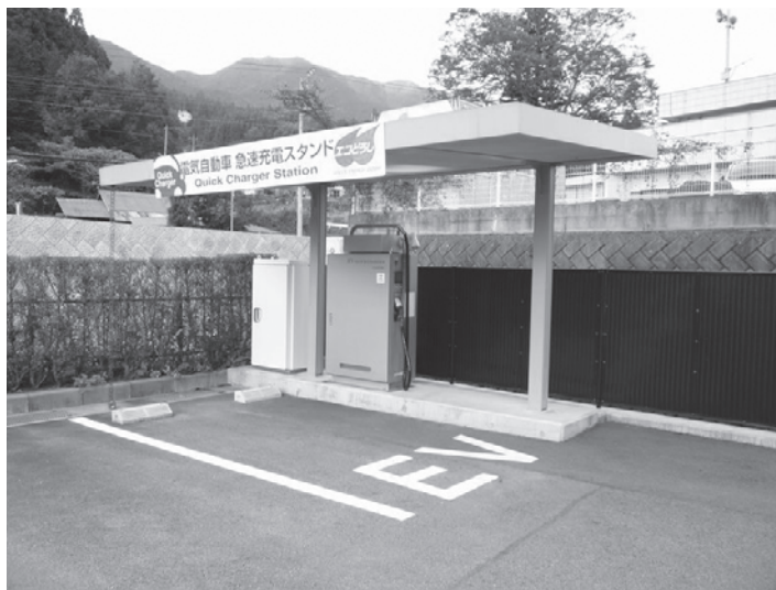
道の駅に設置した「電気自動車急速充電スタンド エコどうし」
