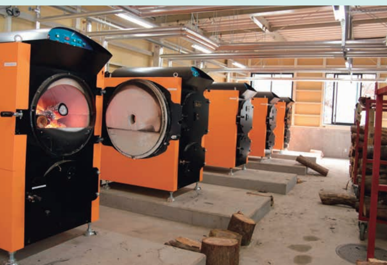
「道志の湯」に導入した薪ボイラー。間伐材を燃料に利用する ● 山梨県道志村 (p18-19)
