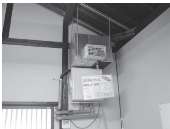
ヒートポンプ設置状況
