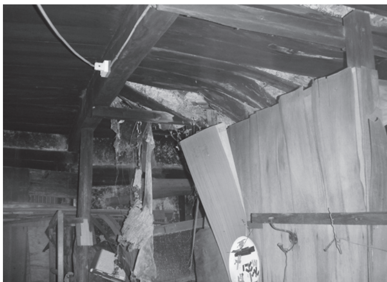
空き家の内部。屋根が崩落寸前となっている
