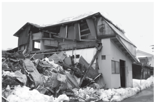
豪雪で倒壊した空き家
