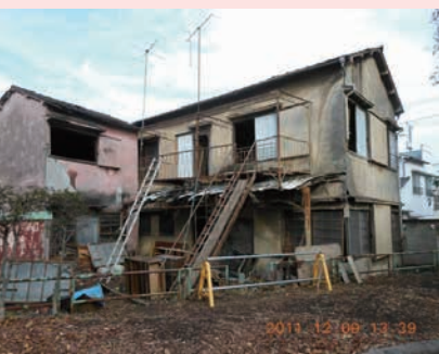
老朽化し危険な空き家
