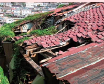
着工前の老朽危険空き家
