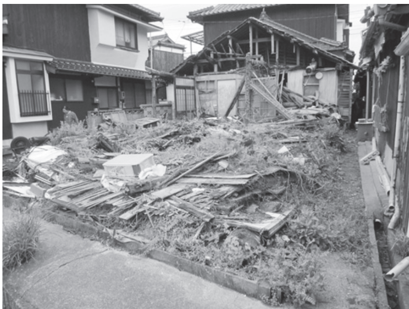
放置された空き家
