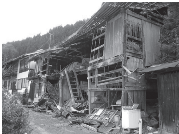
倒壊寸前の空き家
