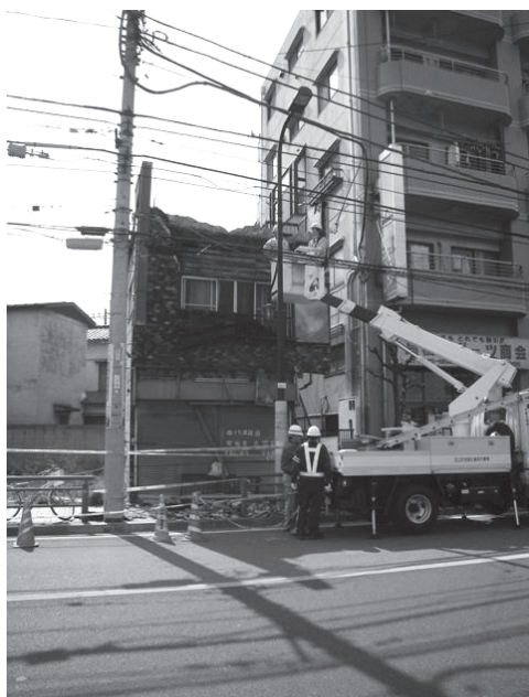
解体される前の危険家屋
