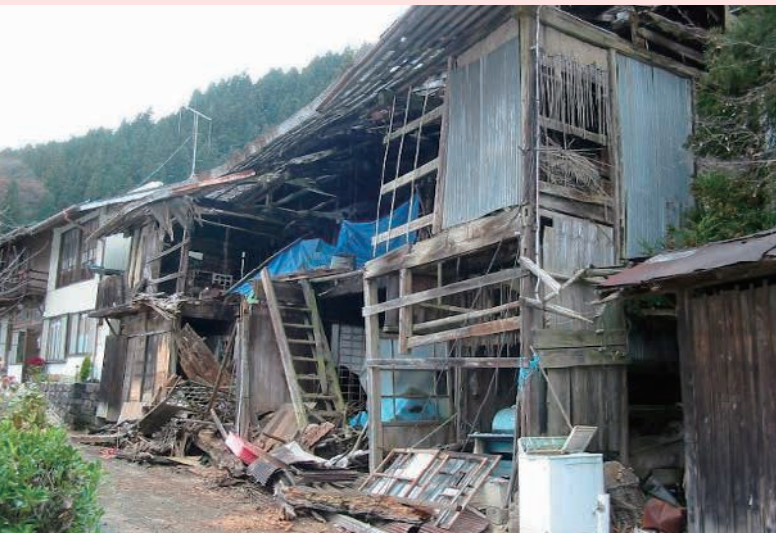
倒壊寸前の空き家
