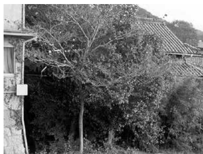
修繕前の拠点候補：敷地全体が木に埋もれていました
