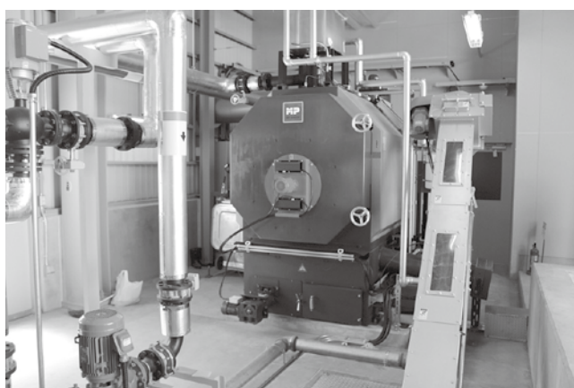
文化会館内木質ボイラー。乾燥チップを燃料に540kwの冷暖能力
