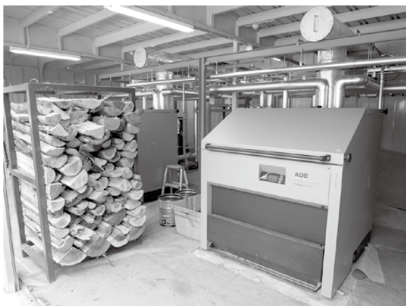
今年、村内の温泉施設、黄金泉に導入した薪ボイラー
