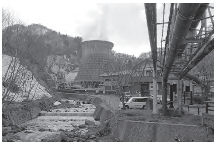
松川地熱発電所
