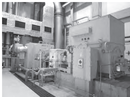
蒸気タービン発電機
