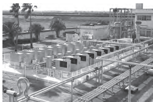
消化ガス発電機
