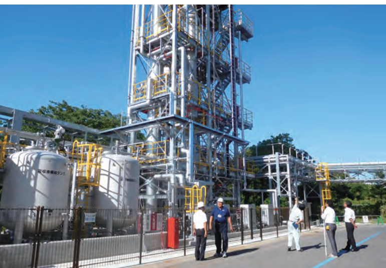
二酸化炭素分離回収設備
