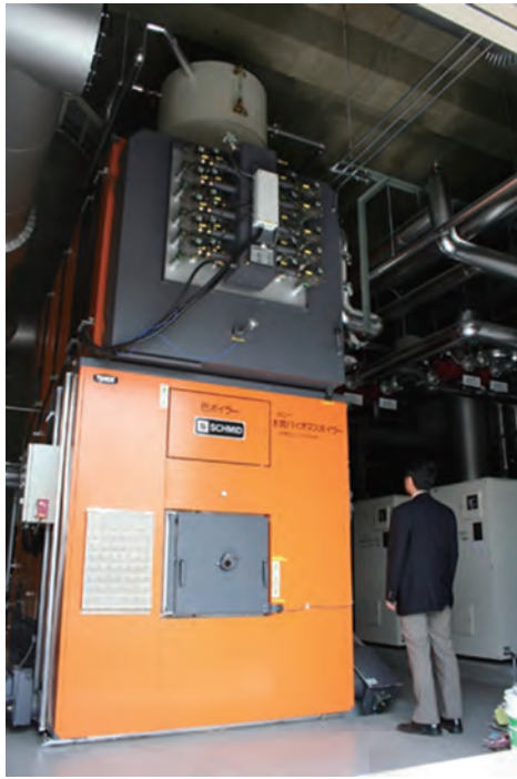
● 北海道下川町 (p8-9) 地域に熱供給する木質バイオマスボイラー
