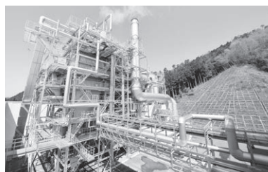
バイオマス発電所
