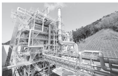
バイオマス発電所
