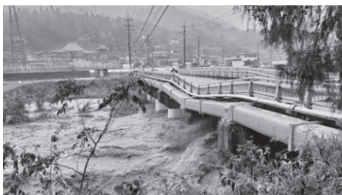
台風19号で被害をうけた山梨県大月市の様子
