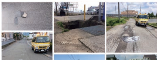
さばればで投稿された道路損傷写真
