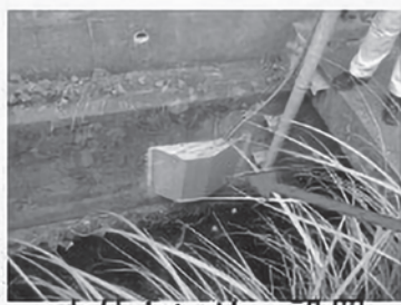
水位センサー設置(例)
