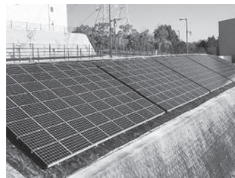
市民共同発電所4号機 (市民エネルギー生駒)
