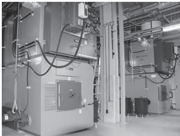
11 基の木質バイオマスボイラーから、 31 の公共施設に熱エネルギーを供給
