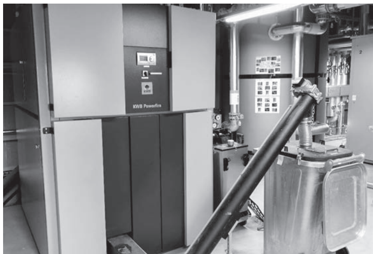
役場庁舎の木質バイオマスボイラー
