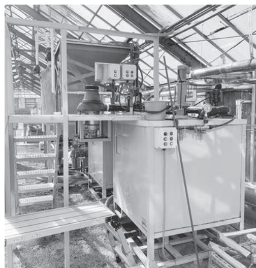
クラウドファンディングで移設した バイオマスプラント
