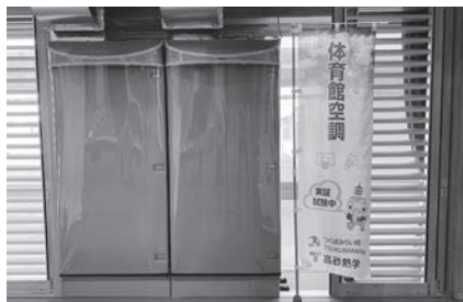
体育館向け空調システム
