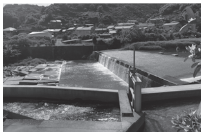
小水力発電所風景。手前の水門水路の鉄板の下にタービンが設置されている
