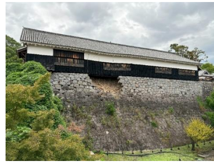
石垣が崩れたままの熊本城内
