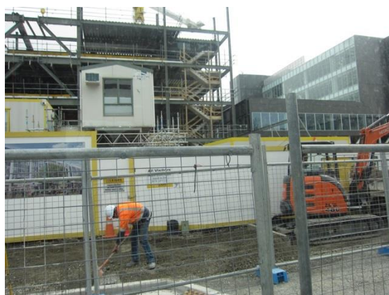
写真 6. 復旧中のクライストチャーチ市街の様子（筆者撮影）
