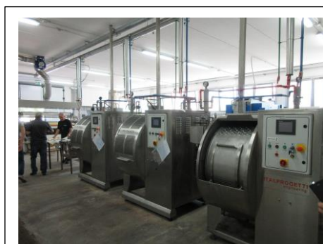
施設内には革製造の一連の工程が行えるよう各種機械が備わっている
